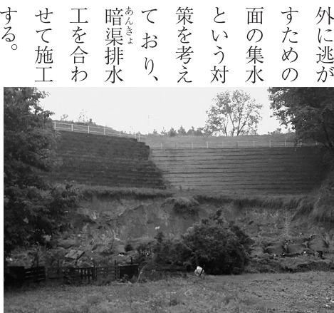
斎場のり面崩落現場
