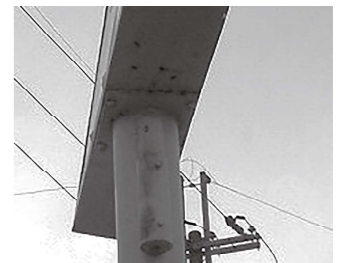
▲さび色の水が垂れたような跡(内部が腐食しているかも)
