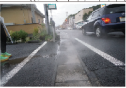
排水溝から吹き出る煙 臭いを感じられる
