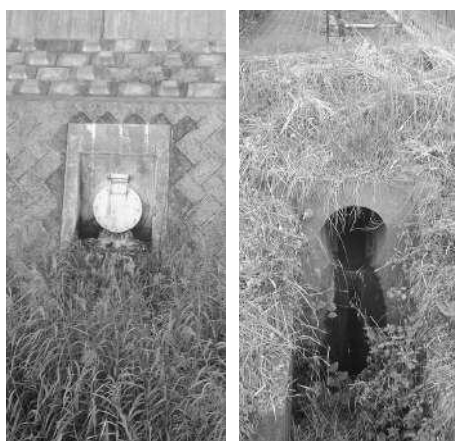
古川の逆流防止弁(左)と皆沢川の排水路
