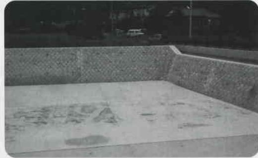
浸水対策調整池
