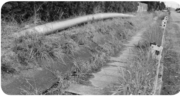
下水道管が液状化被害で浮き上がった（潮来市）
