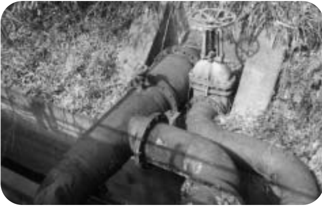
老朽化したバルブ(楠木揚水場)
