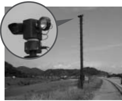
【情報収集】流域各所に設置した無人観測所で雨量・水位を観測、ライブカメラ(左)でも川の状態を常時監視しています。
