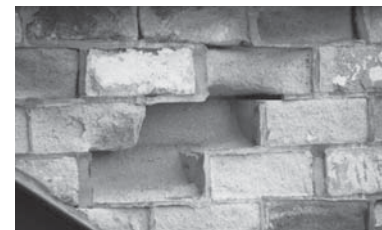
劣化による煉瓦の欠落部分
