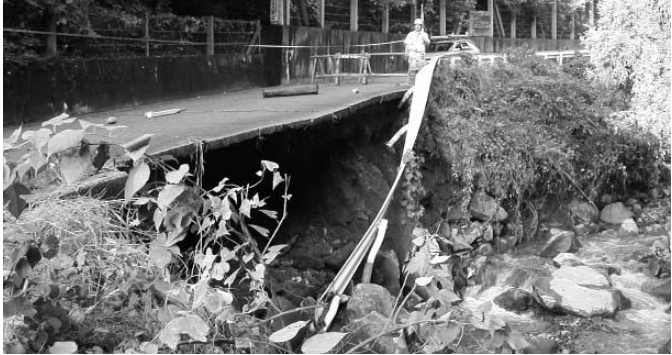
台風 22 号による被災のようす
