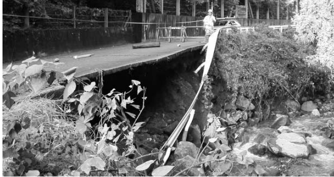
台風 22 号による被災のようす
