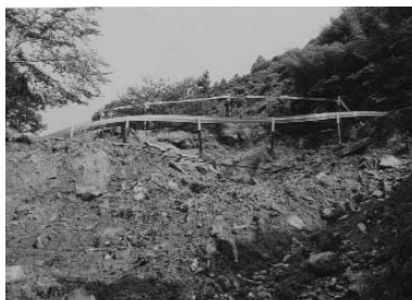
台風11号による災害査定を受けた市道葦1115号線(葦山山水)
