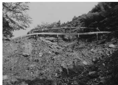
台風11号による災害査定を受けた市道葦1115号線(葦山山木)
