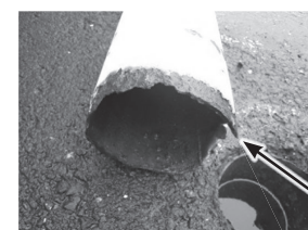
▲柱根元のさび(折れて倒壊するかも)
