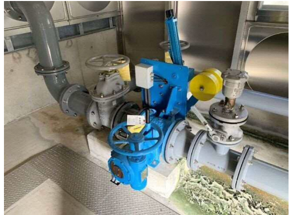
緊急遮断弁 (星和立花配水池)
