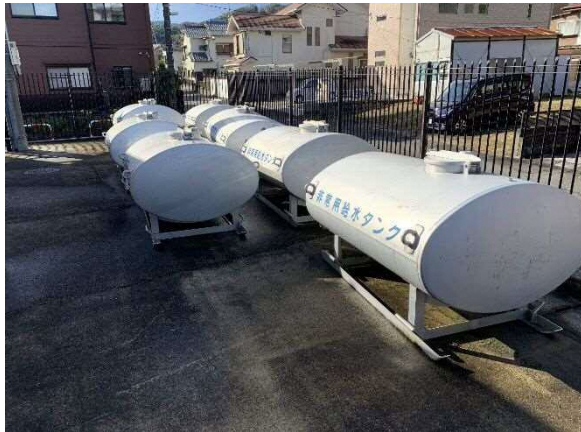
非常用給水タンク (古奈配水池)
