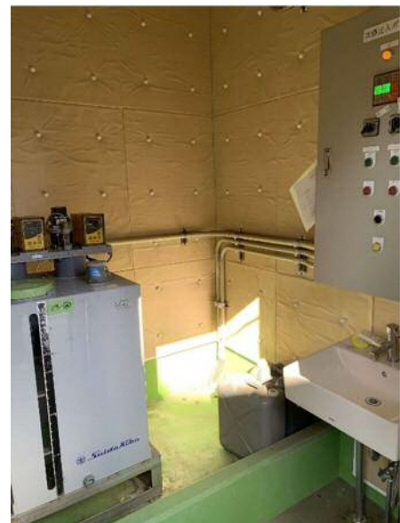
四日町水源 (次亜塩素酸ナトリウム注入設備)
