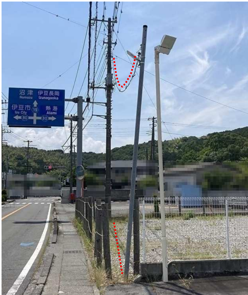
南西角外側の電柱から南東角外側の街灯に架かる電線が越境している可能性
