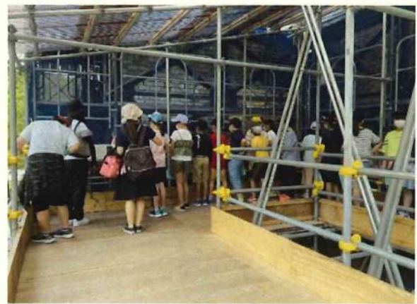
葦山反射炉保存修理工事 工事用足場を使った見学用ルート
